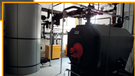
3. kép: faapríték tüzelésű kazán
